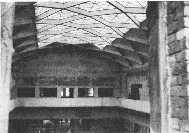
Fig. 4. — Toiture de l'Université de Kaunas (Lituanie) ; portée 20 m, hauteur utile 50 cm, pas de poussée horizontale.
