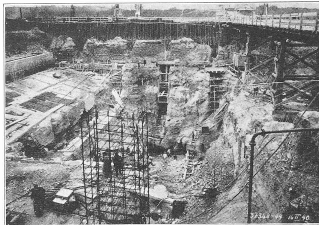
Fig. 2. — Chantier de l'usine (fondations des groupes 1 et 2) à l'intérieur du batardeau rive droite, en février 1940.
