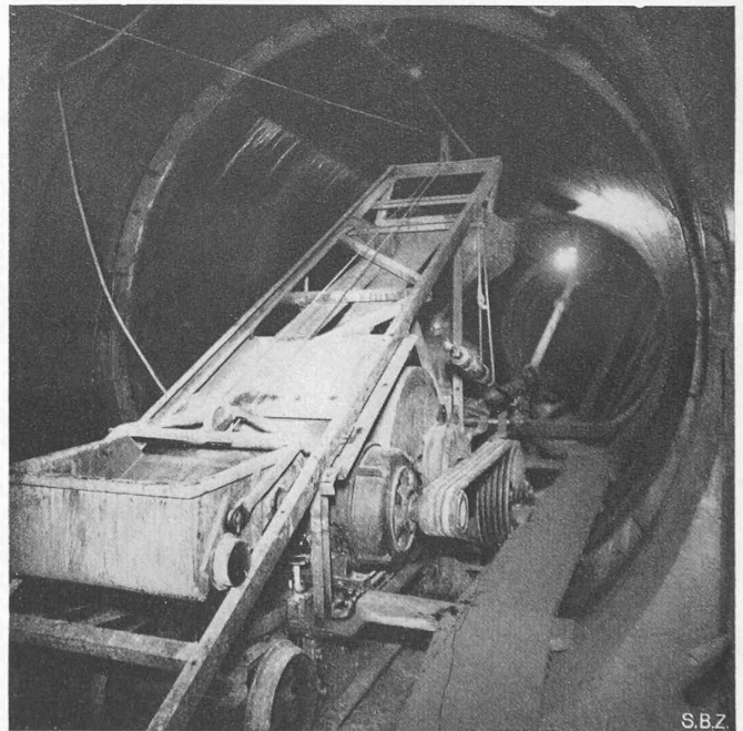
Fig. 9. — Exécution de la galerie d'amenée. — La pompe à béton et sa benne d'alimentation pour un débit de 7 m 3 /h ; sous le plan incliné, le moteur de 30 ch de la pompe à béton.
