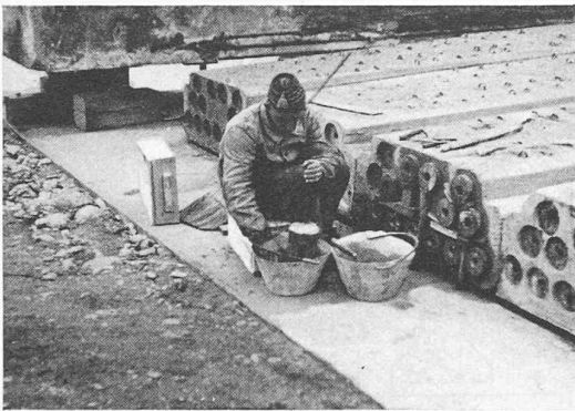
Fig. 4. — Pont de Fribourg. Cônes d'ancrage femelles scellés dans niches ménagées à l'extrémité des poutres.
