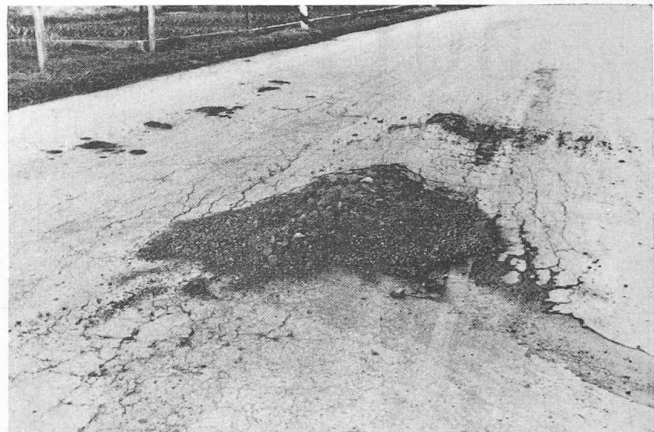
Fig. 2. — Type de chaussée munie d'un revêtement bitumineux et fondée sur sol glaiseux-sableux, détruite par le gel de l'hiver 1941-1942.
