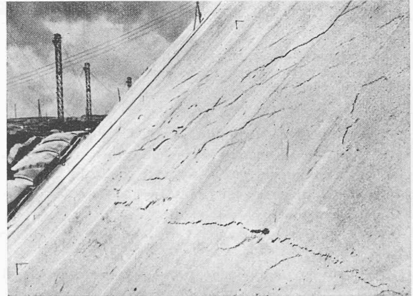
Fig. 25. — Déformation du parement amont.
