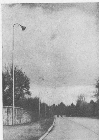
Fig. 6. — Luminaires à optique directrice, montés sur candélabres en tube de fer.
