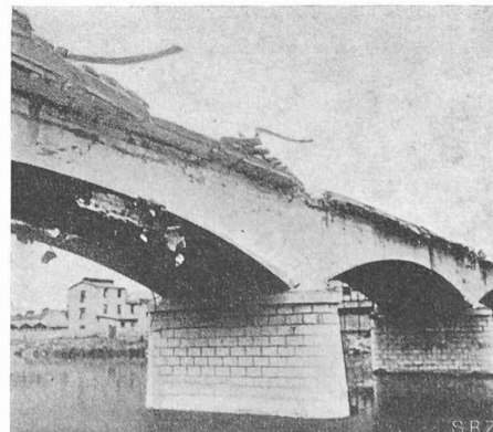
Fig. 30. — Pont de Moscou, près de Montereau. Etat de l'ouvrage avant la remise en état.
