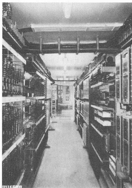
Fig. 11. — Genève-Cornavin, Poste I: Vue du local à relais. On voit à droite, au premier plan, des jeux de relais de commande d'aiguille, à connecteurs.
