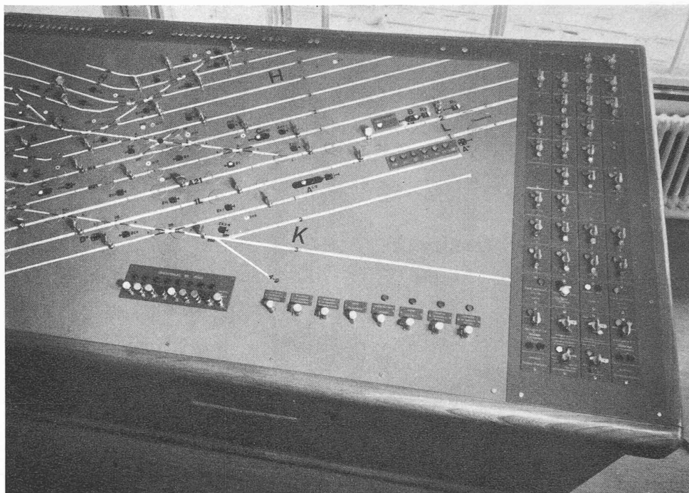
Fig. 10. — Genève-Cornavin, Poste I: Vue de détail du pupitre de commande Integra. On voit à droite du pupitre une partie des leviers individuels de secours de commande des aiguilles. Ces leviers sont plombés.
