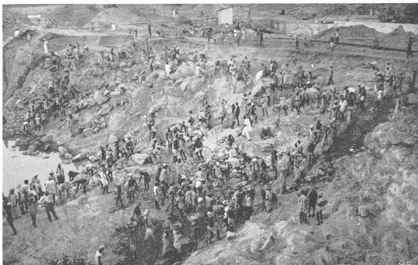
Fig. 8. — Excavation des fondations pour le barrage de Konar I (Damodar Valley Authority).
