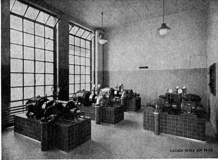
5 compresseurs «ROTASCO» pour la réfrigération les entrepôts frigorifiques
