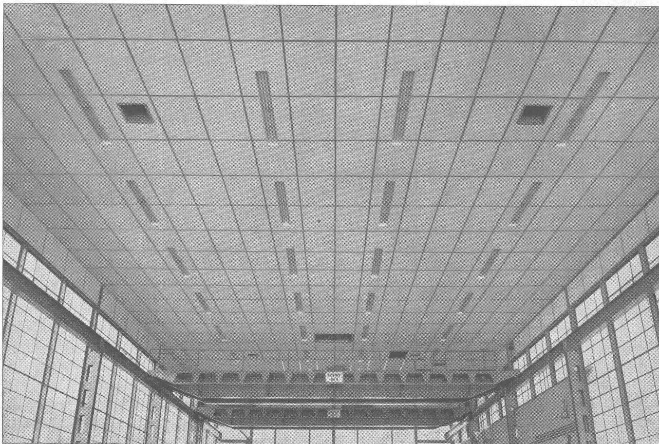
Plafond VETROFLEX dans la nouvelle halle de montage des ateliers de Constructions Mécaniques S. A. à Renens.
