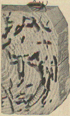
Pièce de charpente rongée par les larves d'hylotrupe
