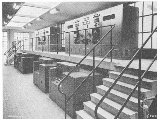
Fig. 4. — Convertisseurs à contacts pour une installation d'électrolyse, 4 \times 10\,000 A sous une tension continue de 350 V.
