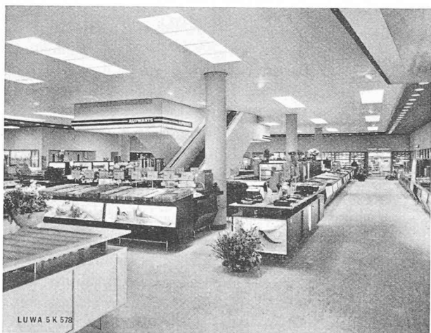
Fig. 2. — Etage de vente de grand magasin avec double plafond perforé pour pulsion d'air conditionné.
