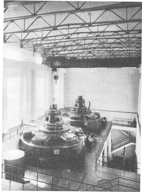
Fig. 6. — Vue intérieure de la centrale d'Agra.
