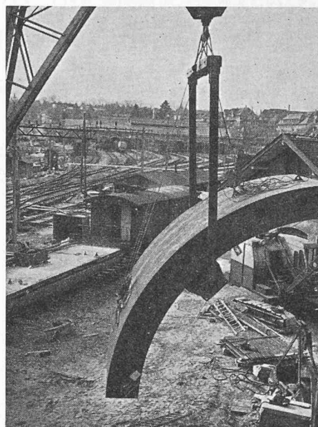
Fig. V/3. — Mise en place d'un élément du bouclier dans le puits à l'aide d'une grue C.F.F. de 25 t.
