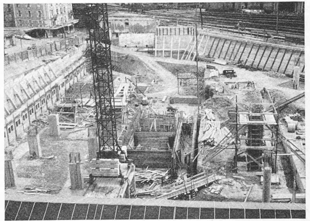
Fig. 5. — Etat du chantier, en cours d'exécution des sous-sols. On distingue le mur côté voies et le mur autostable le long de l'avenue d'Ouchy avec butons obliques.
