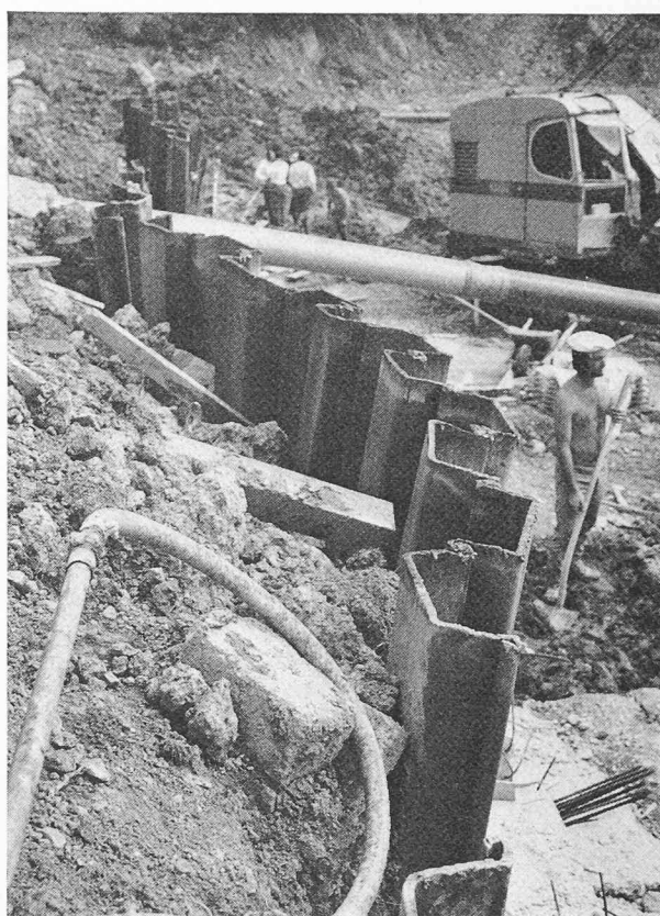
Fig. 3. — Basculement des palplanches.
