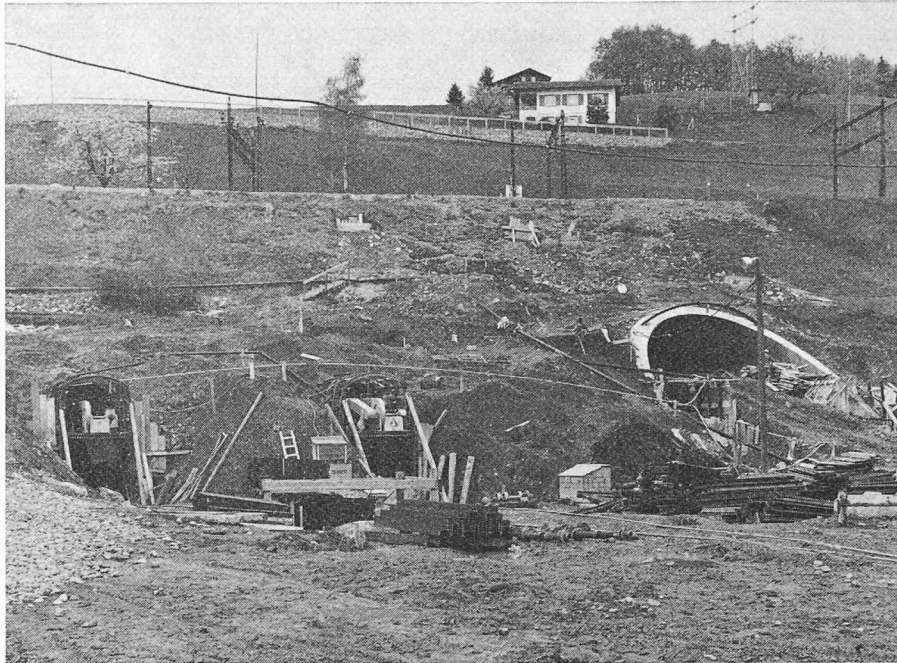
Fig. 3. — Vue des entrées Est. Tunnel amont : excavation de la calotte terminée. Tunnel aval : exécution des galeries de base.
