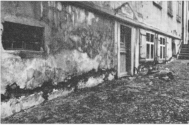
Fig. 2. — Maçonnerie fortement pénétrée d'humidité. Prise de vue durant le montage de l'installation électro-osmotique d'assèchement. Voir aussi figure 8.
