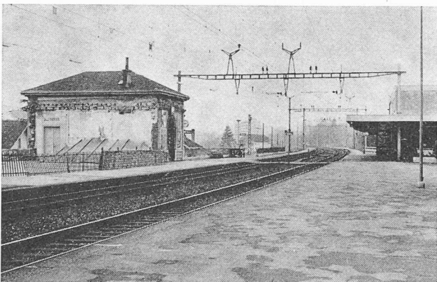
Fig. 87. — Rolle : à droite, le nouveau bâtiment de la station. On distingue, sur le quai de gauche, l'ancien bâtiment en cours de démolition (photo Yves Jault).
