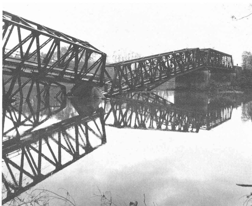
Le pont sur la Toce, près de la gare de Verbania. On distingue la pile qui a basculé, minée par les eaux en crue.
