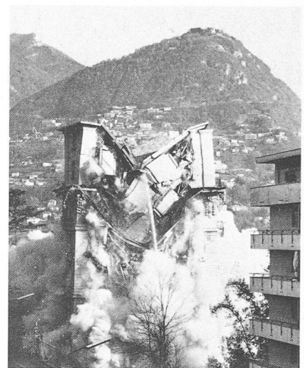
Fig. 4. — Début de chute de la façade côté lac (à droite).
