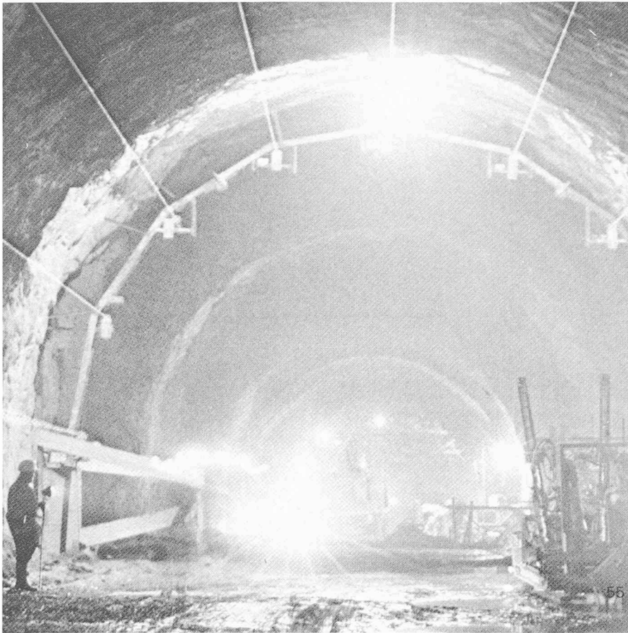
Fig. 7. — Au lot nord on utilisait pour le contrôle et le marquage du profil d'excavation neuf appareils-lasers montés sur un portique le long du pourtour du tunnel. Ils étaient déplacés régulièrement à chaque étape d'avancement de 300 m. Les rayons lasers servaient aussi au marquage du schéma de forage sur le front d'attaque du tunnel.
