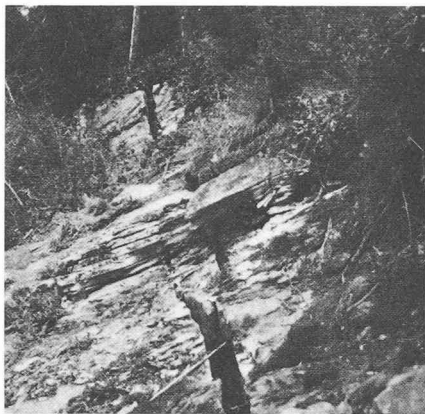
Fig. 3. — Grande fissure, à l'amont.
