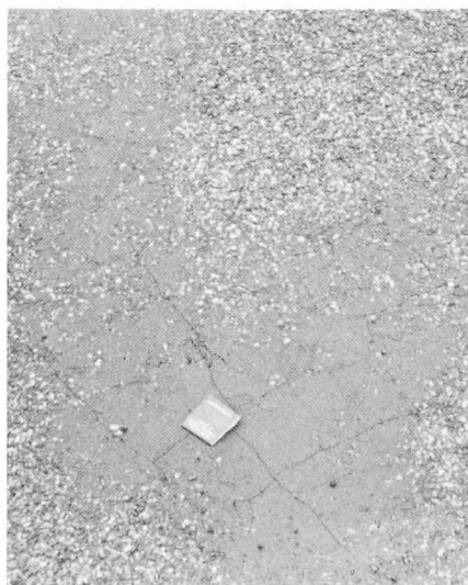
Fig. 6. — Ce revêtement d'asphalte coulé s'est désagrégé après un hiver seulement, l'étanchéité étant épaisse et trop tendre.
