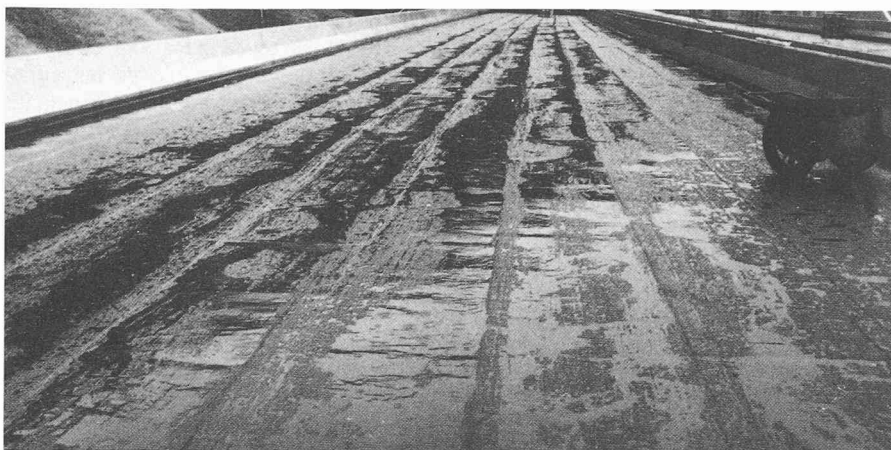
Fig. 8. — Les joints entre des feuilles à base de bitume modifié forment une retenue d'eau qui reste dans les pores de l'enrobé.
