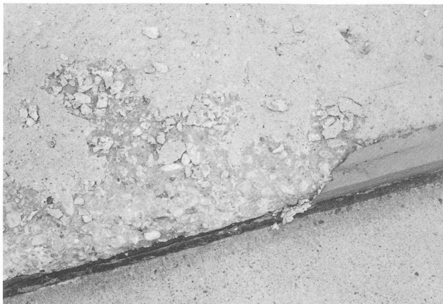
Fig. 4. — Béton désagrégé par le choc de température provenant du sel de déneigement. On remarque très bien la différence entre le béton de la surface et celui du noyau. Une protection ne peut pas empêcher cette désagrégation.
