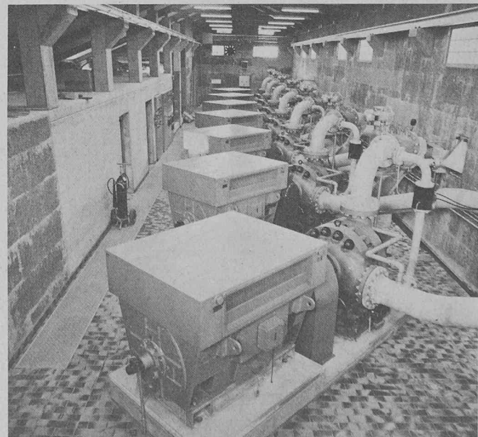
Installation de Tannwald (Suisse) comprenant 7 pompes normalisées mises en parallèle, développant une puissance totale de 6,5 MW.
