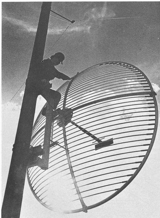
Montage d'une antenne sur pylône, destinée à la liaison radiophonique par canaux multiples.
