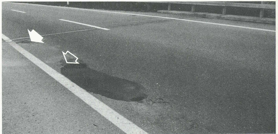
Fig. B2. — Vue en direction du joint de dilatation inférieur où un trou provoqué par des chocs a été réparé; l'échantillon 1 a été prélevé dans cette zone à l'avant de la réparation longitudinale du revêtement.
