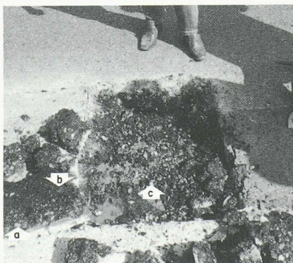
Fig. B3. — Echantillon 1: le revêtement en enrobé, d'une épaisseur totale de 11 cm, a sa couche inférieure désenrobée (a). Sur les faces de rupture, le bitume se détache du gravillon (b). L'étanchéité est recouverte de gravillon désenrobé et d'eau stagnante provenant du revêtement (c).
