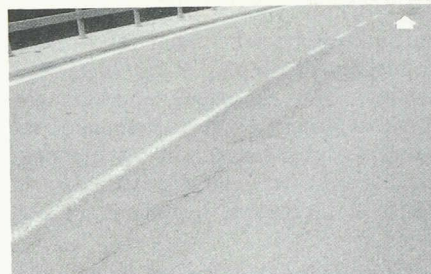
Fig. A2. — Dégât au revêtement avec fissures du tapis hydrocarboné dues à la poussée. Les teneurs en vides de la partie du revêtement endommagé s'élevaient à: 5,1-7,5% (volume) dans la couche d'égalisation; 4,0-7,4% (volume) dans la couche d'usure. (La flèche indique l'endroit où l'on a prélevé un échantillon; cf. fig. A3.)
