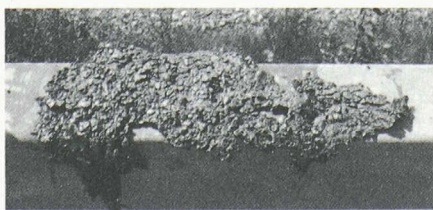
Fig. B5. — L'étanchéité qui a été enlevée, avec le béton qui y adhère (à l'envers).
