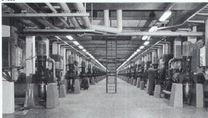
Installation d'épuration Lynetten, Copenhague, 115 pompes TURO.
