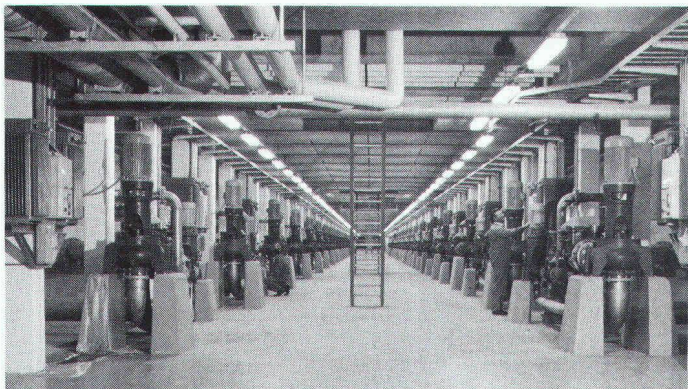
Installation d'épuration Lynetten, Copenhague, 115 pompes TURO.
