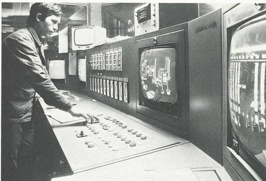
Pupitre de commande à la salle centrale de commande. L'affichage de toutes les données importantes et la conduite du processus s'effectuent par quatre écrans commandés par ordinateur.
