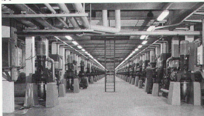
Installation d'épuration Lynetten, Copenhague, 115 pompes TURO.
