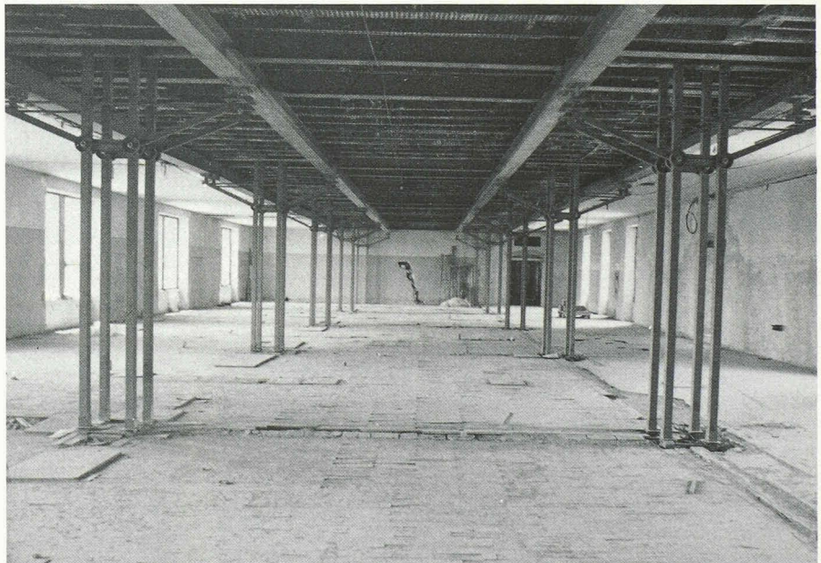
Fig. 1. — Vue intérieure du bâtiment, d'une largeur de 16 m, avant la mise en place du cloisonnement.
