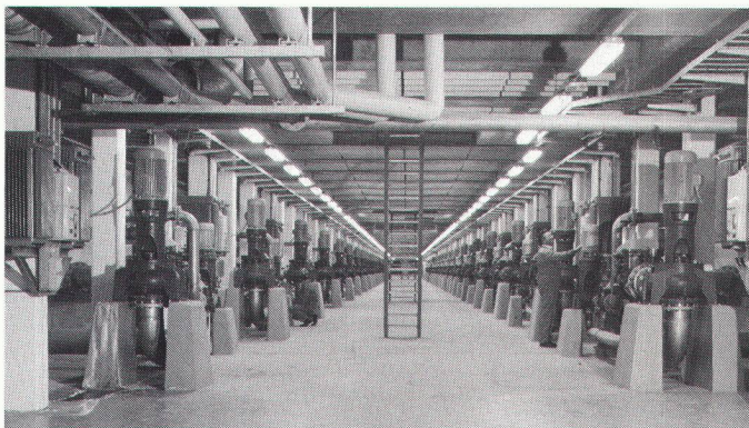
Installation d'épuration Lynetten, Copenhague, 115 pompes TURO.
