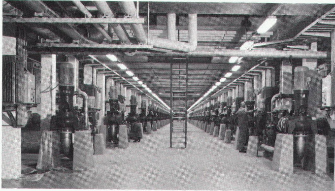
Installation d'épuration Lynetten, Copenhague, 115 pompes TURO.
