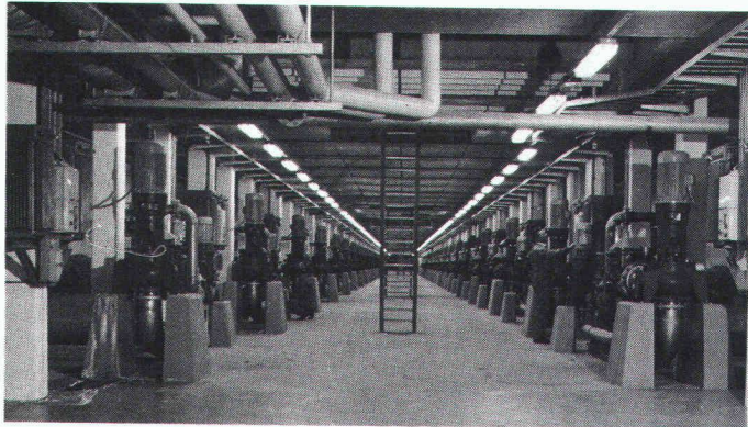
Installation d'épuration Lynetten, Copenhague, 115 pompes TURO.
