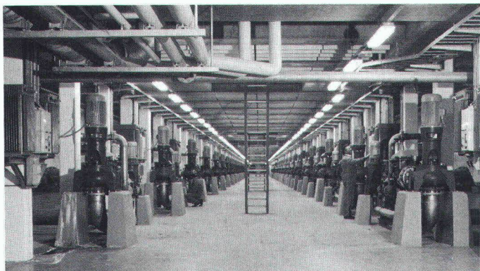
Installation d'épuration Lynetten, Copenhague, 115 pompes TURO.
