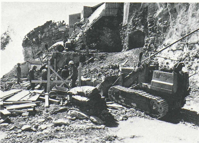
Fig. 4. — Il a d'abord fallu créer une plate-forme où puissent évoluer les machines de chantier.
