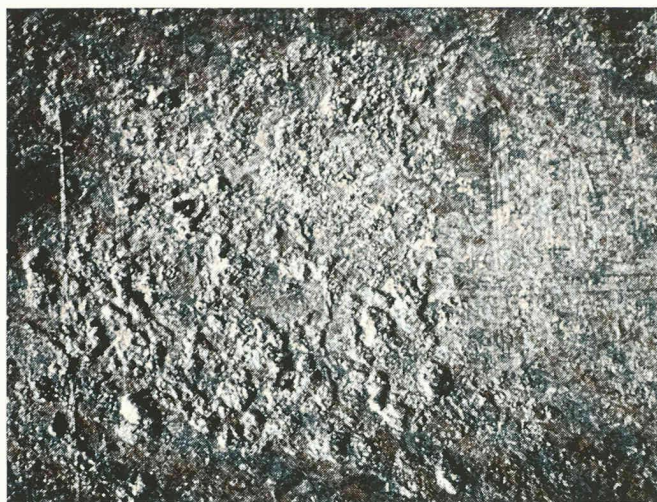
Fig. 3. — Attaques par corrosion typiques d'éléments en acier galvanisé exposés librement aux intempéries, dans la zone du trou (après enlèvement de la couche de zinc).
