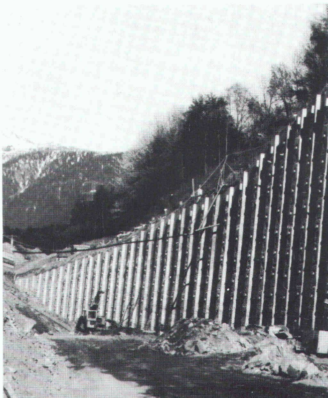
Murs de soutènement dans la partie du tunnel de Gstipf (215 m) réalisée à ciel ouvert.
