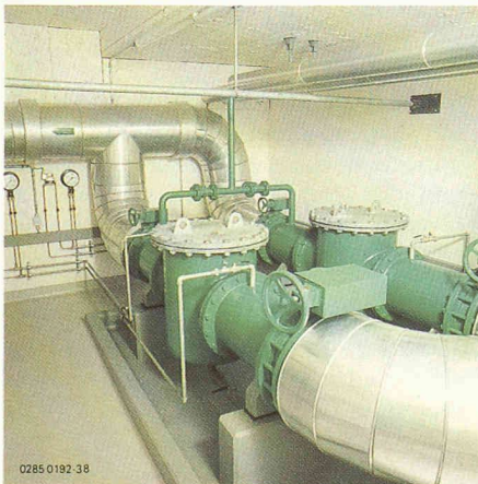
Fig. 3. — Aménée d'eau du lac utilisée comme source de chaleur ; station de filtrage.
