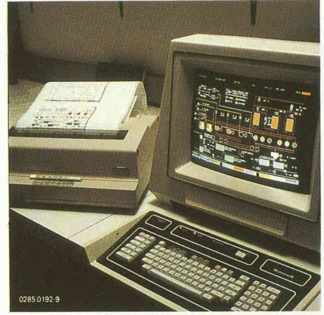
Fig. 9. — Poste de commande régissant la centrale énergétique, équipé d'un terminal couleur et d'un traceur.
