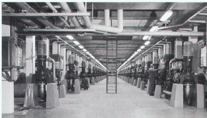
Installation d'épuration Lynetten, Copenhague, 115 pompes TURO.
