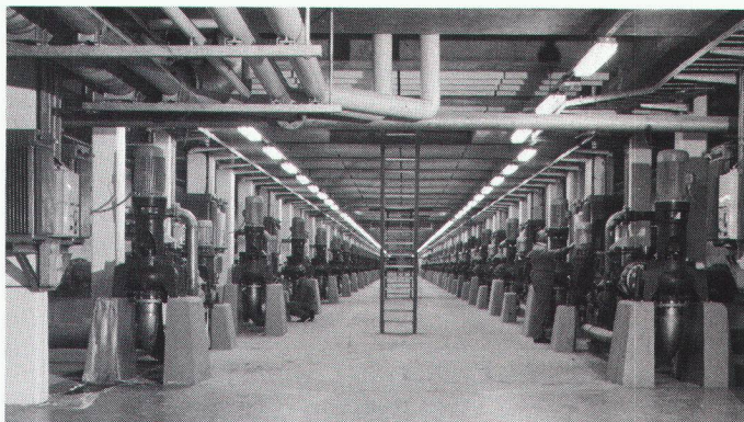
Installation d'épuration Lynetten, Copenhague, 115 pompes TURO.
