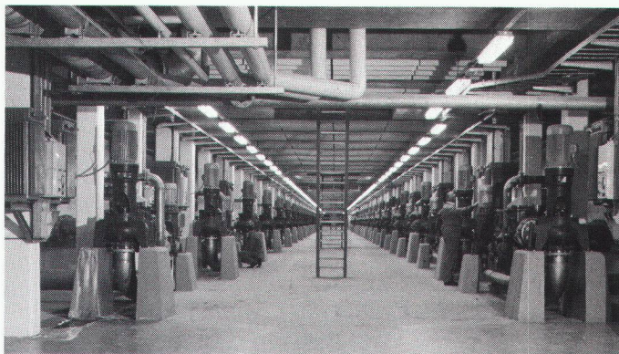
Installation d'épuration Lynetten, Copenhague, 115 pompes TURO.
