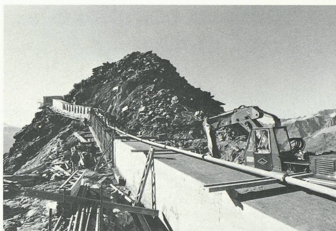
Fig. 4. - La galerie de communication entre le bâtiment principal et la partie ouest en cours de bétonnage (état au 23.10.1985).
