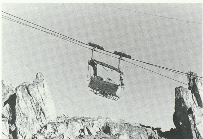
Fig. 6. - Le téléphérique de chantier (charge utile 3,0 t) a été démonté à la fin des travaux.
