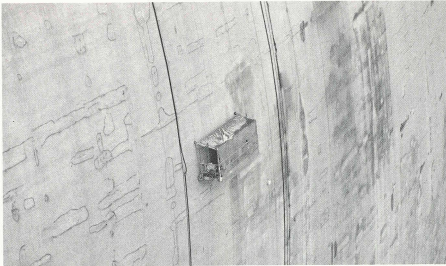
Le barrage-voûte exige une manœuvrabilité extrême des échafaudages suspendus. Les plates-formes de travail ont une largeur de 1,20 m pour assurer une mise en place correcte du béton projeté. En outre, elles doivent supporter des outillages lourds et différentes conduites. Avant le début des travaux de réfection, l'étendue des dégâts a été répertoriée et ceux-ci signalés à la peinture directement sur le parement.
