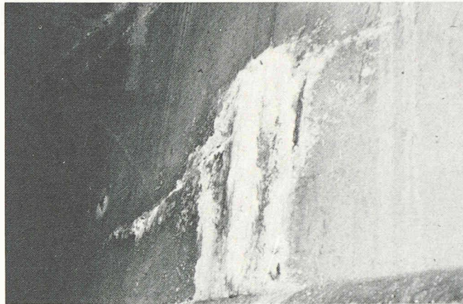
Fig. 13. – Percolation de l'eau à travers une structure en béton précontraint: encore une fois, on a trop compté sur la pérennité de la chape d'étanchéité.
