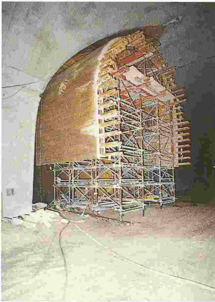
Tunnel est. Coffrage spécial utilisé pour le bétonnage des galeries transversales assurant la liaison entre les deux tubes.
