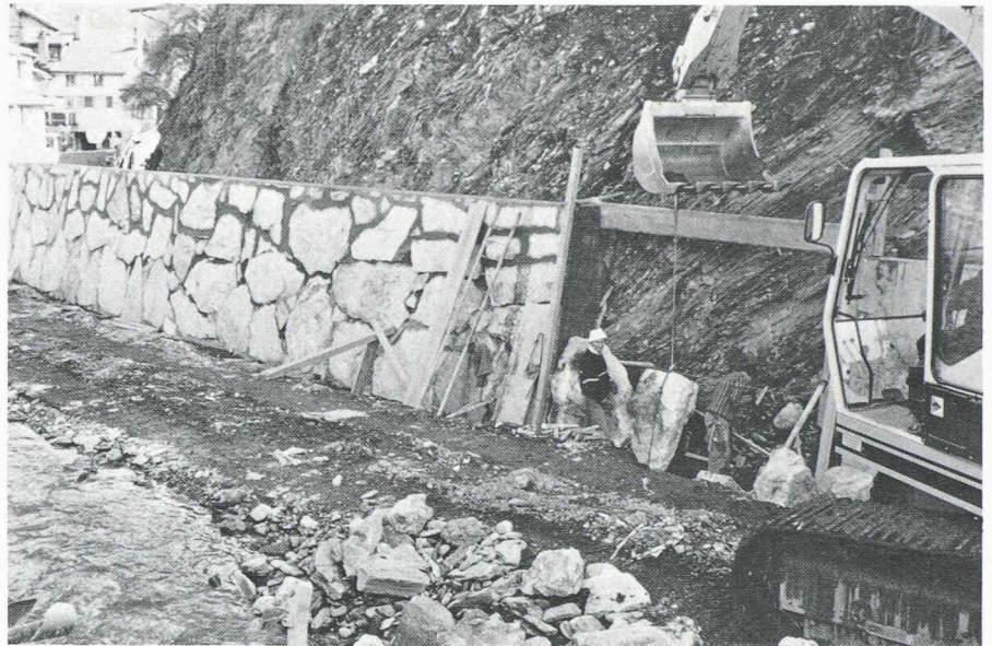
Fig. 4. – La Lienne à Saint-Léonard (VS). La destruction des structures morphologiques passe même par des enrochements bétonnés devant... des parois rocheuses.
