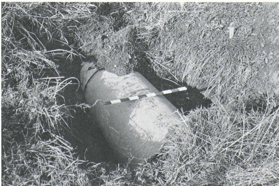
Fig. 6. – Canal du Rosey à Savagnier (NE). La remise à ciel ouvert d'un ruisseau mis en voûtage s'avère extrêmement difficile à cause des limites cadastrales fixées en excluant l'emprise d'un cours d'eau.
